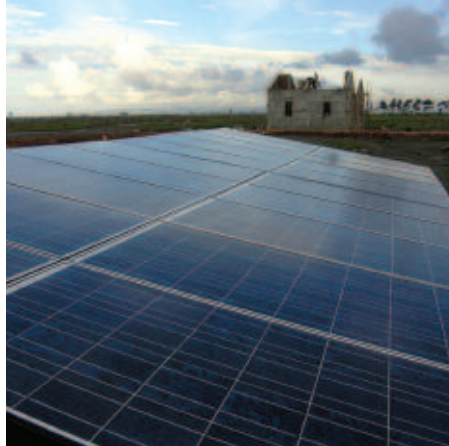
Immagine in collaborazione con UPLINK, una ONG locale per lo sviluppo. Greenpeace ha offerto le sue competenze in materia di efficienza energetica e energie rinnovabili: ha aiutato a installare generatori di energia rinnovabile nel villaggio costiero di Aceh, Indonesia, una delle aree più colpite dallo tsunami nel dicembre del 2004.
